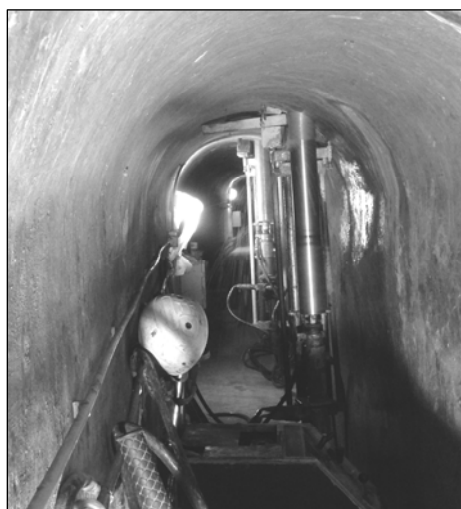
Figura 9 – Carotatrice utilizzata nei cunicoli orizzontali per la perforazione delle canne drenanti \Phi 120
